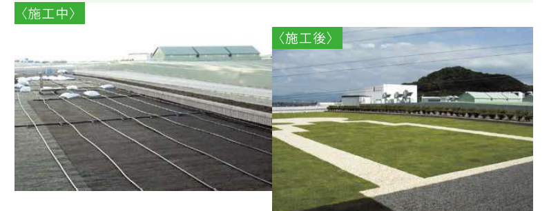
硬質ドリップチューブ使用例:屋上緑化
